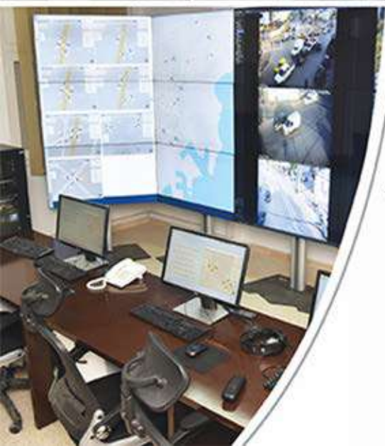
Centre de Contrôle et de Supervision à la Municipalité de Sfax مركز المراقبة و التحكم ببلدية صفافس Control and supervision center in the municipality of Sfax
